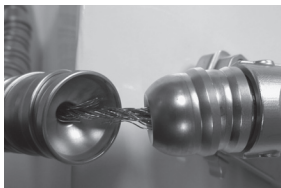
Figur 8 – Kabel som uppvisar utmattning och nötning
