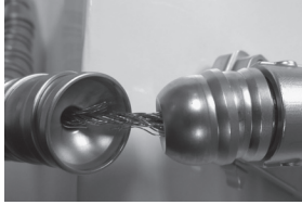
Şekil 8 – Yorulma ve yıpranma görülen kablo
