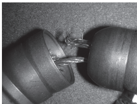
圖 4 - 磨損電纜的外觀 - 請勿使用
